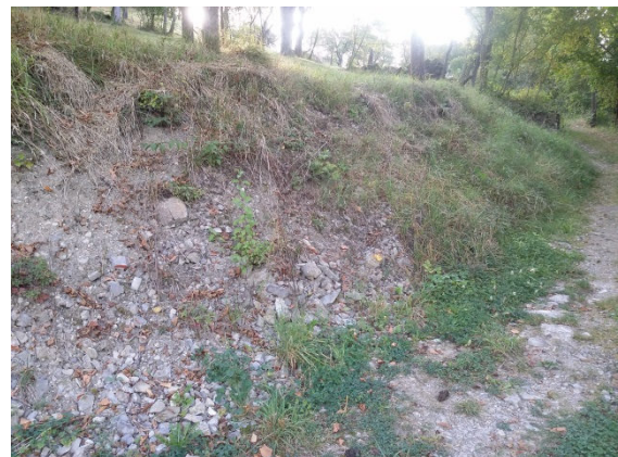
Abbildung 7: Ehemalige Trockenmauer an der Künzelsauer Sonthalde. Nachdem sie langsam einstürzte wurde sie komplett entfernt.
