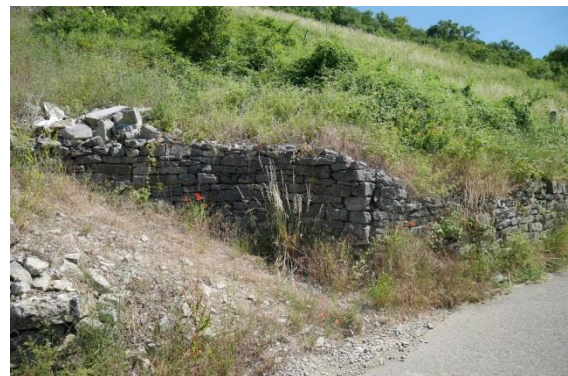
Abbildung 7: Verfallene Trockenmauer am Hoheberg in Ingelfingen
