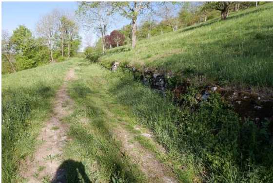
Abbildung 14: Trockenmauer am Ellbach in Forchtenberg vor der Sanierung
