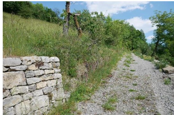
Abbildung 16: Trockenmauersanierung an der Sonthalde in Künzelsau - Steine einer ehemals vorhandenen Trockenmauer sind nur noch rudimentär vorhanden
