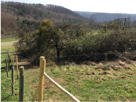
Foto 6: Nachdem der Festzaun installiert ist, werden die Ziegen den ganzen Sommer auf der Fläche weiden und so den starken Gehölaufwuchs zurückdrängen.
