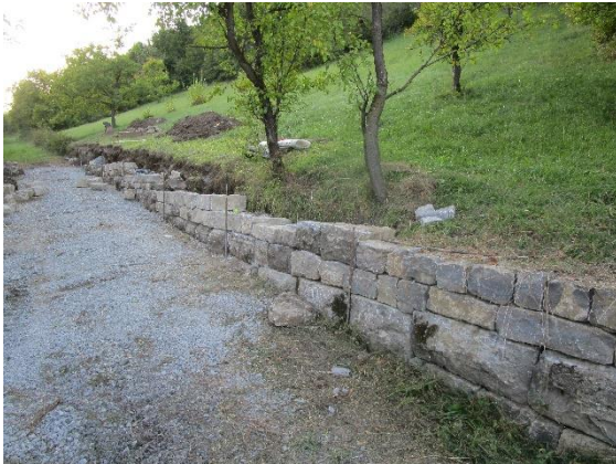
Foto 19: Neben der Trockenmauer in Ailringen wurden auch noch Mauern in Schöntal, Öhringen, Krautheim, Ingelfingen, Forchtenberg und Künzelsau saniert.
