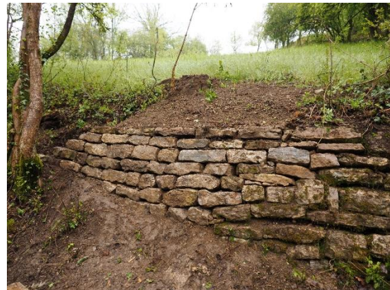
Foto 12: Trockenmauer nach der Sanierung. Das Moos wurde entfernt und die Mauer wird nun durch den Gehölzrückschnitt wieder besonnt.
