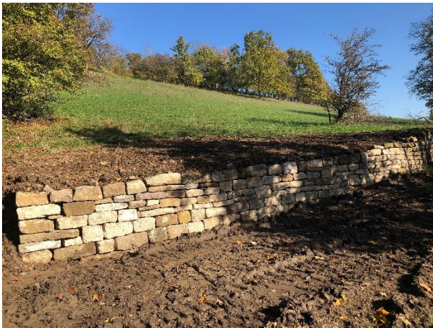
Abbildung 20: Der sanierte Abschnitt. Als Abschluss wurde eine Ecke gesetzt, um die neu entstandene Auffahrt abzusichern.
